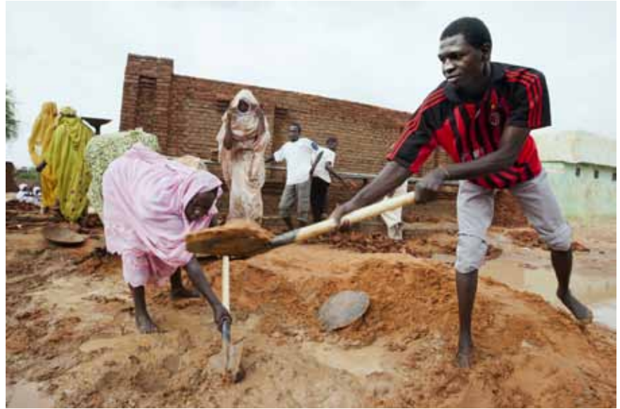
في ١٥ أغسطس ٢٠١٢، شباب يعملون في الثورة الشمال، شمال دارفور لصناعة طوب أسمنتية لبناء مركز اجتماعي في احد مشاريع اليوناميد المجتمعية كثيفة العمالة. تصوير ألبرت غونزاليز فاران، اليوناميد.
